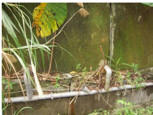
照片三 中和垃圾掩埋場之擋土牆龜裂
