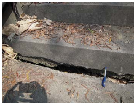
照片二 大里垃圾掩埋場往復育公園 的階梯有明顯變位
